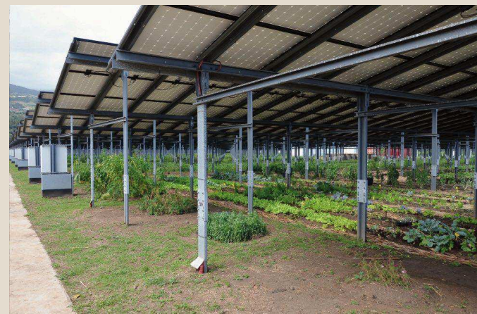
La centrale photovoltaïque des Cèdres supporte une production agricole et fournit l'équivalent de la consommation électrique de la ville de l'Etang-Salé.
